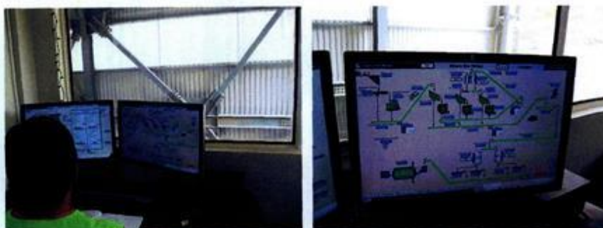
Imagen 36 y 37. Controles de trituración en cabina de control ubicada en área "100 y 150".
