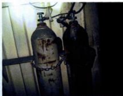
Imagen 18. Estado en que están los cilindros de oxígeno.
