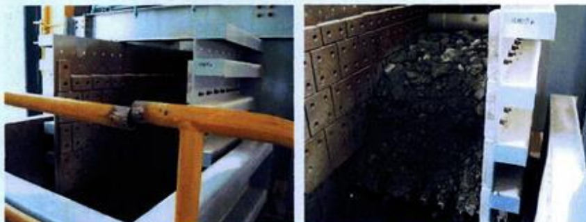
Imagen 38. Pasamanos en malas condiciones.
