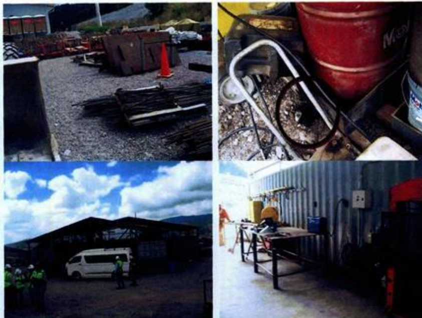
Imagen 52. Bodega de insumos y materiales a la intemperie.
