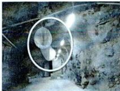
Imagen 7. Tubería de ventilación instalada dentro del polvorín, la misma circula por varios accesos del túnel.
