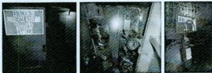
En estas fotografías se observa el sistema de rotulación y el equipo de seguridad que se localiza dentro y fuera del área de comedor en el interior del túnel.
