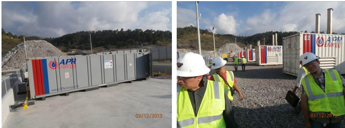
Imagen 68 y 69. Instalaciones de la planta de generación de energía.
