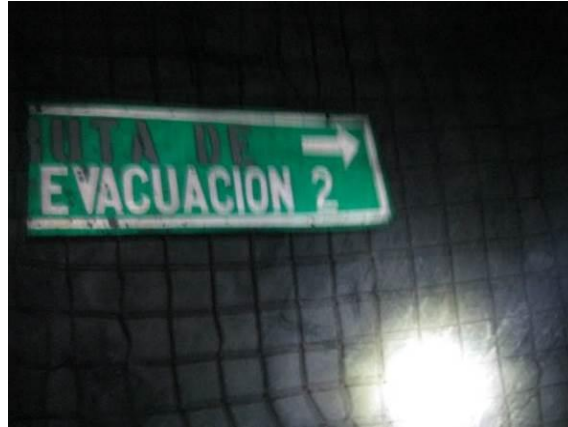
Imagen 15. Señalización en mal estado y colocada deficientemente.
