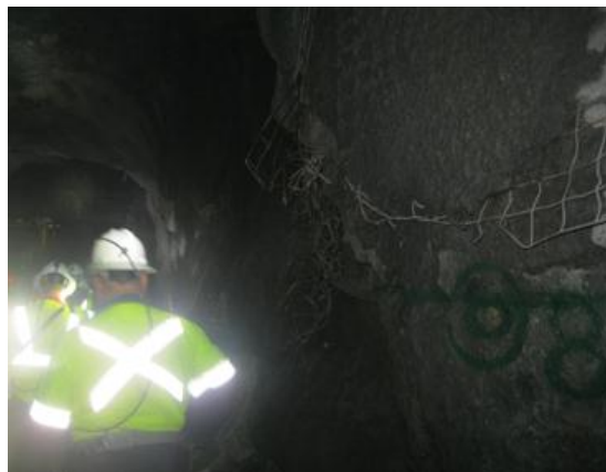
Imagen 02. Malla de refuerzo en mal estado y se requiere reforzamiento.
