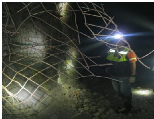
Imagen 01. Estado deficiente de la malla
