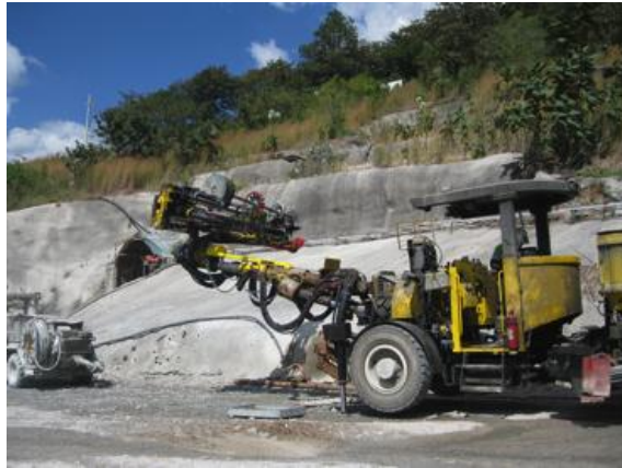
Imagen 22. Área de estacionamiento de maquinaria y lavadero de la misma.
