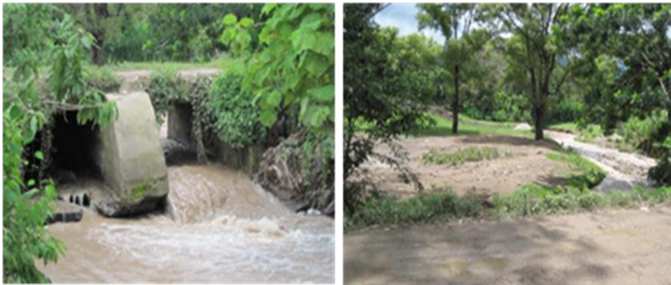
Fotografía 8.4 Puente sobre el río El Dorado antes de llegar al río San Rafael que se desbordó durante la tormenta Agatha.
